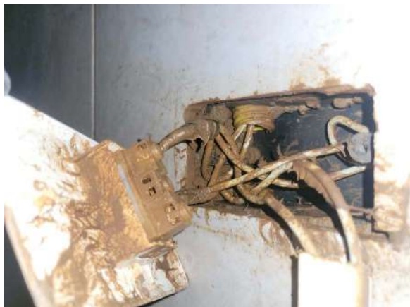
Fotografia 1: Tomada atingida pela enchente de maio de 2024, em São Leopoldo (RS). Fonte: Registrada pelo autor.
