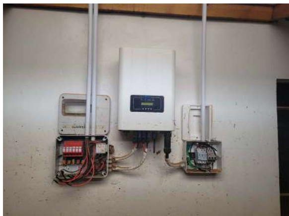
Fotografia 2: Inversor solar e stringbox atingidos pela enchente de maio de 2024, em São Leopoldo (RS). Fonte: Registrada pelo autor
