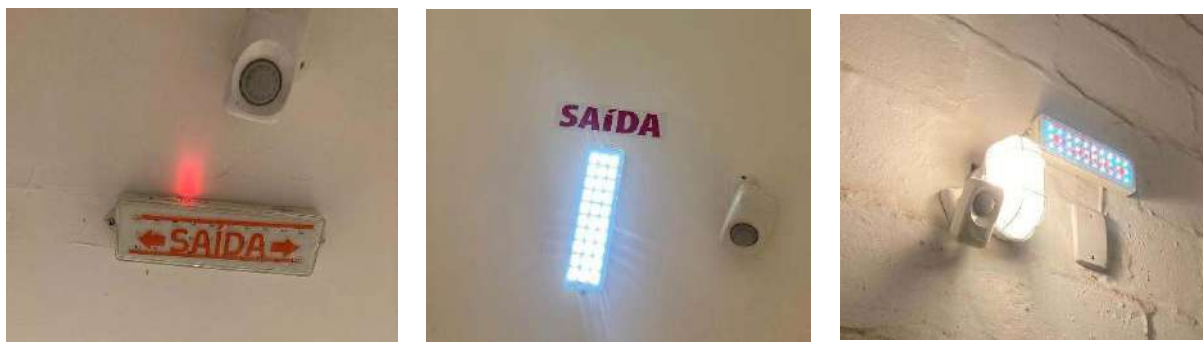
Fotos 1, 2 e 3: O adesivo de “SAÍDA” sobre a iluminação não é permitido.
