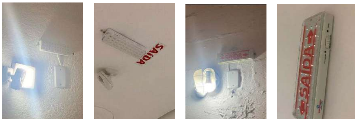
Fotos 4, 5, 6 e 7: No condomínio existem diversas luminárias em falha e/ou desligadas.
