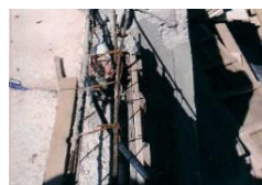
Vista da descontinuidade do concreto da viga D
