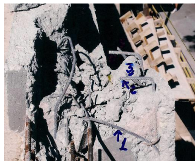
Vistas da falta de armadura negativa e da ancoragem insuficiente da viga lateral
