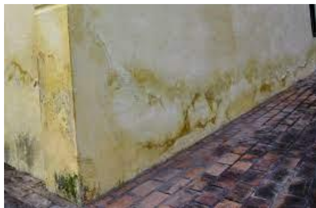
Figuras 06, 07 e 08: imagens de umidade e fissuras.
